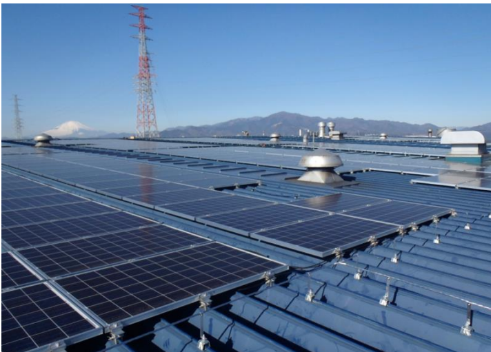
【日産工機工場の屋根上に設置した太陽光発電パネル】
