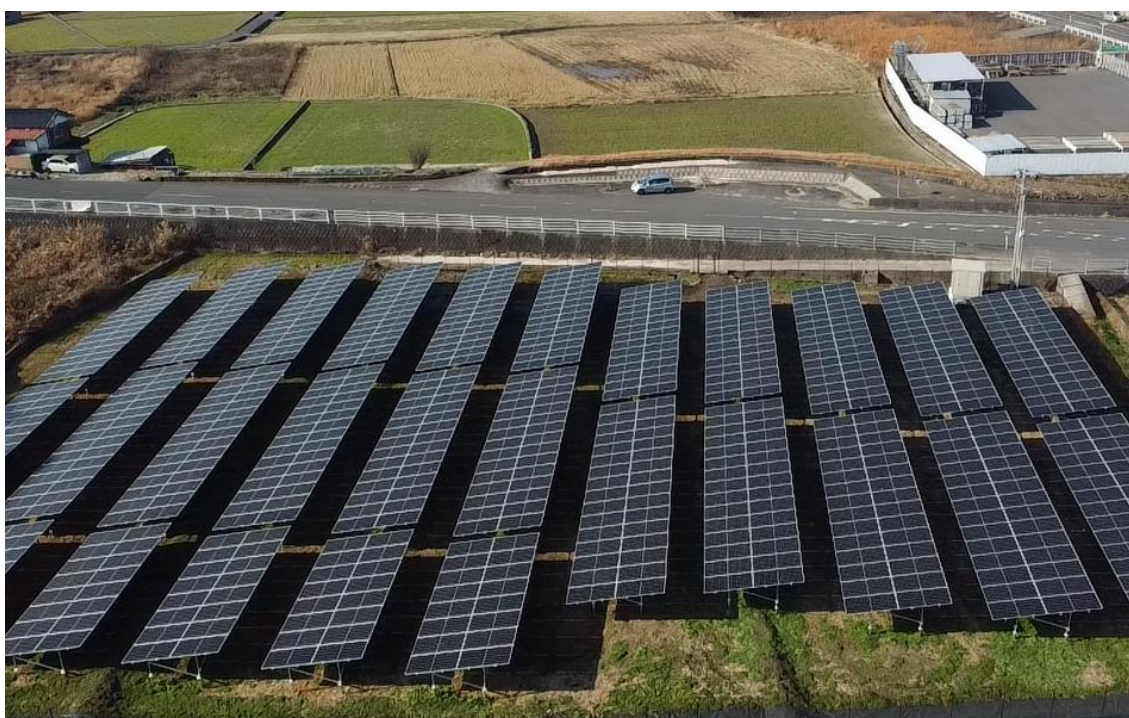
岩国太陽光発電所
