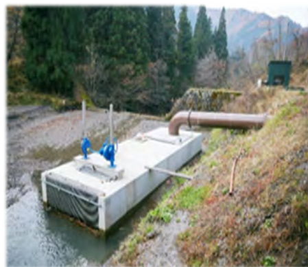
小水力発電施設
