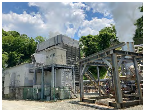
隣地にて稼働中の地熱発電所1号機
