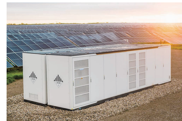
▲再エネ併設蓄電池
